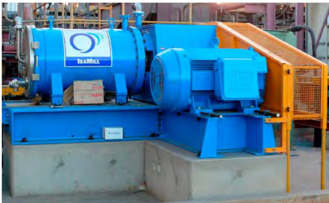
Рисунок 11. Мельница IsaMill™ с двигателем 200 кВт на обогатительной фабрике Cosmos
