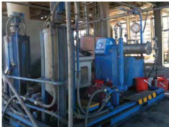
Рис. 10. Для проектирования и масштабирования цикла доизмельчения меди и пирита была использована пилотная установка IsaMill M20
