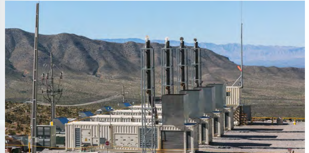
LNG Gensets at La Encantada
