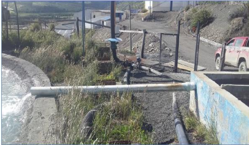
Imagen 1. Canalización de rebalse de agua potable
