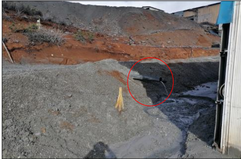
Imagen 1. Canalización para aguas de escorrentía.
