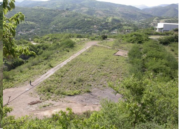
Figura 12.- Estado actual de la cobertura de pasto en el bordo de la presa de jales Pastización efectuada en 2004? con pasto llanero ( Andropogon sp)
