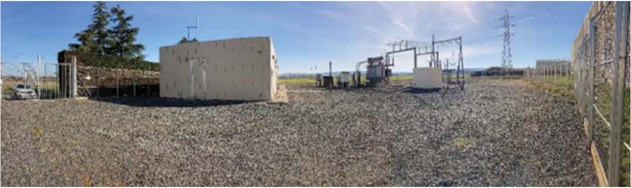
FIG. 40 - POSTE RTE DE BELLENAVES 63 000 VOLTS
